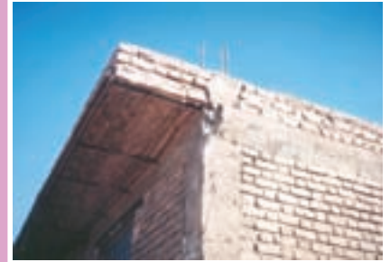
ساختمان نیمه اسکلت با شناژهای افقی و قائم که دچار کم‌ترین آسیب شده است.
