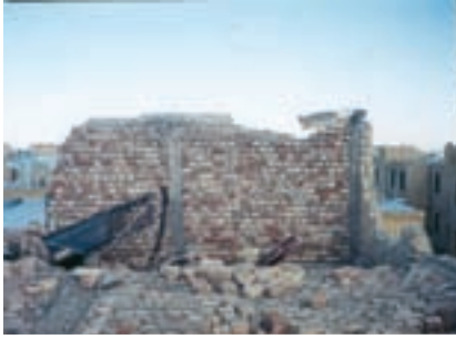
عدم رعایت طول مهارى مناسب در شناژ قائم و عدم اجراء كلاف افقى زير سقف
