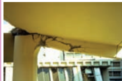
زیاد بودن طول طره و طراحی نامناسب موجب شکست تیر از محل اتصال آن شده است.
