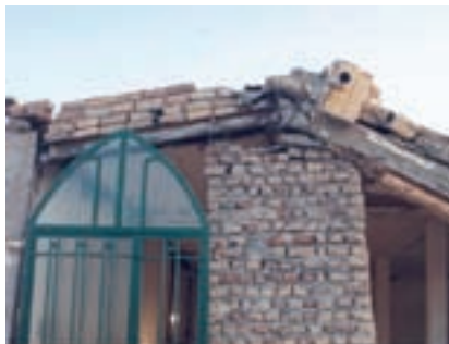
قطع شناژ افقی در محل اتصال با نعل درگاه و بتن نامرغوب موجب ایجاد خسارت به سازه و تخریب قسمتی از آن شده است.
