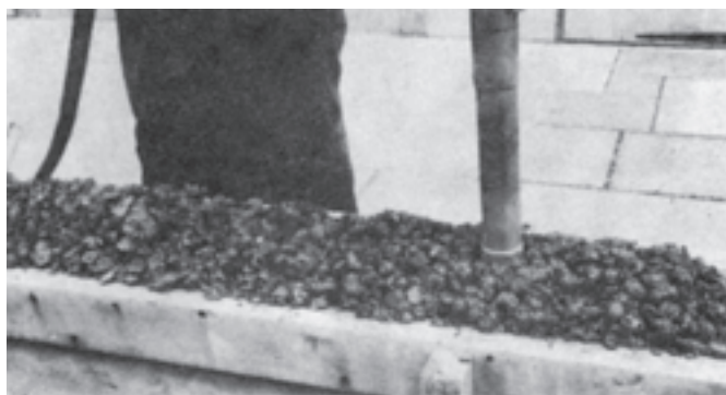
شکل ۶-۱۲- فرو بردن یک لرزاننده میله‌ای در داخل بتن تازه در یک قالب تیر
