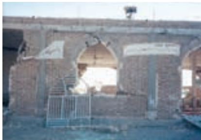
فاصله‌ی زیاد شن‌های قائم و فقدان پیوستگی دیوار به شن‌ها قائم موجب تخریب دیوار شده است.
