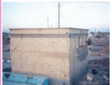
استفاده از آرماتورهای طولی ساده در شناژ افقی بالا بدون قلاب انتهایی و عدم رعایت فواصل خاموت‌ها موجب ایجاد خرابی در سازه‌ی یک طبقه کوچک شده است. در حالی که از چنین سازه‌ی سبکی انتظار می‌رود که در اثر زلزله آسیبی نبیند.
