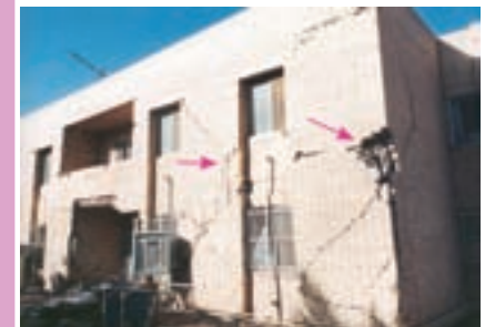
ایجاد ترک‌های قطری در اثر ضعیف بودن شناژ قائم
