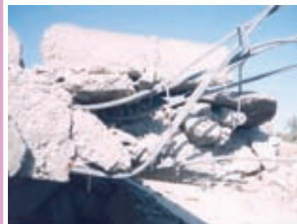
بتن‌ریزی نامناسب در محل اتصال موجب شده تا آرماتور به حد جاری شدن نرسد و بتن جدا گردد.
