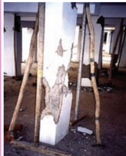
بتن نامرغوب و فاصله‌ی زیاد خاموت‌ها باعث این خرابی شده است.
