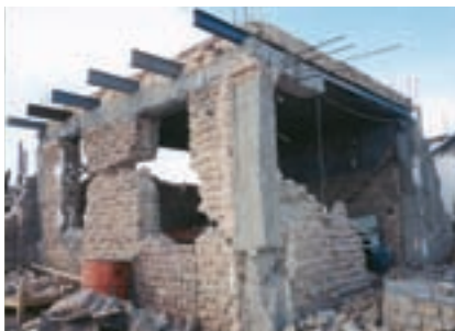
کیفیت نامطلوب بتن، عدم اجرای صحیح شناژهای افقی و قائم و اتصالات آنها موجب تخریب این سازه ی سبک و ساده شده است.
