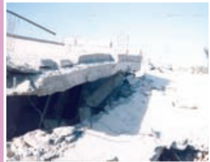
شکست ستون از محل درز اجرایی
