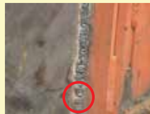
عدم جوش پیوسته - لوچه
