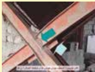
ضعیف بودن جوش و عدم اتصال مناسب
